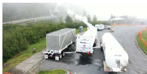
The LNG truck and vaporizer at Portage.
